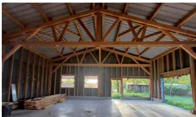
Aujourd'hui, le bâtiment est un simple abri, qui doit être viabilisé (isolation, huisseries, etc.).
